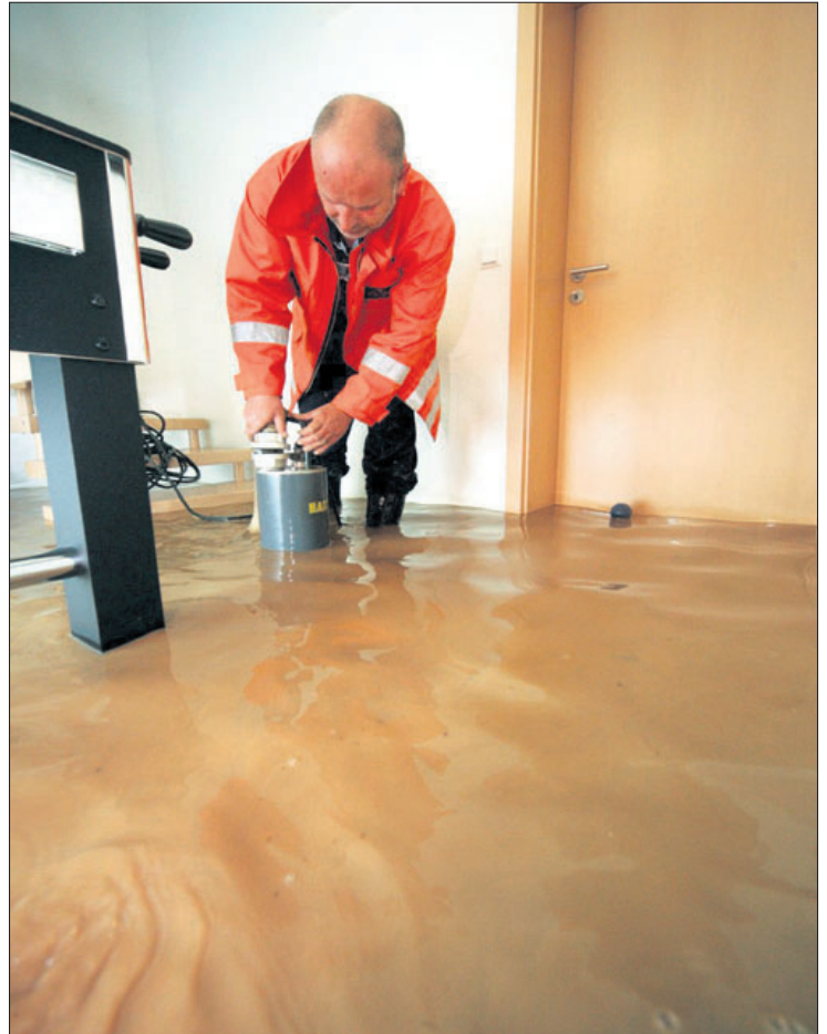
Ein am 30. Mai vollgelaufener Keller in der Kleinheppacher Brühlstraße. 14 Häuser waren hier laut Verwaltung betroffen. Weil Bachverdolung und Kanalschächte verstopft waren, suchten sich Wasser und Schlamm ihren Weg in die Häuser. Archivbild: Habermann
